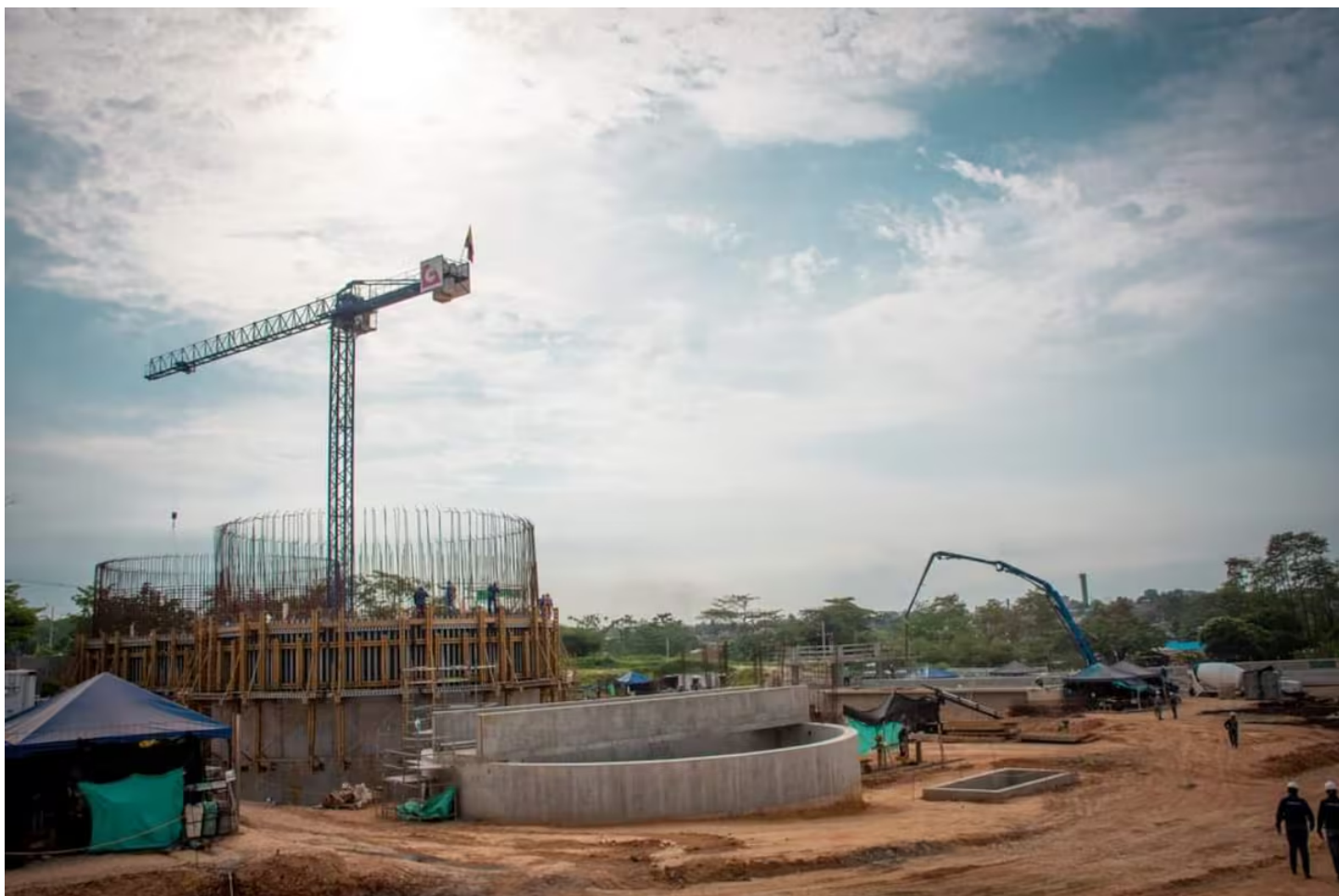
La PTAR San Silvestre continúa sin una reactivación efectiva de las obras, mientras Aguas de Barrancabermeja estudia la posible siniestralidad del contrato. Archivo/Suministrada/Vanguardia
