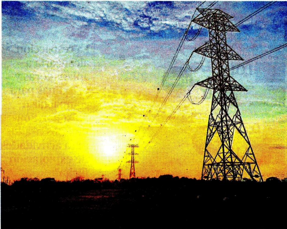
Línea de transmisión Chinú-Urabá de la compañía Interconexión Eléctrica ISA. Foto: Cortesía
