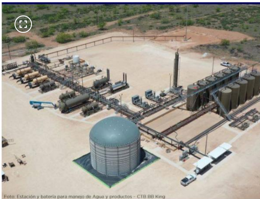
Foto: Estación y batería para manejo de Agua y productos - CTB BB King
