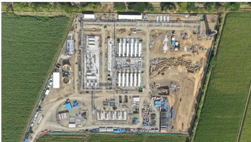
Regasificadora del Pacífico. Imagen: Regasificadora del Pacífico
