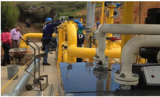
Gas natural FOTO:SUPERSERVICIOS
