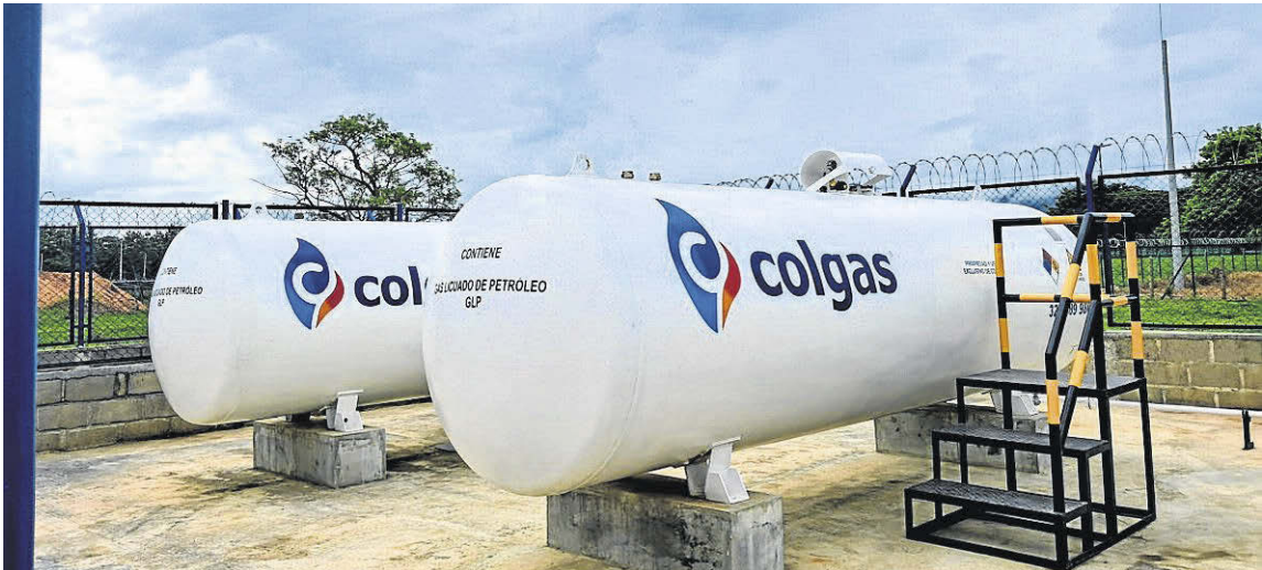
Tanques de almacenamiento de la Red de Gas Natural Sintético (GNS), que se instaló en el barrio Montevideo, en Tierralta (Córdoba) e inaugurado este viernes. //FOTO: HFA - EL UNIVERSAL
