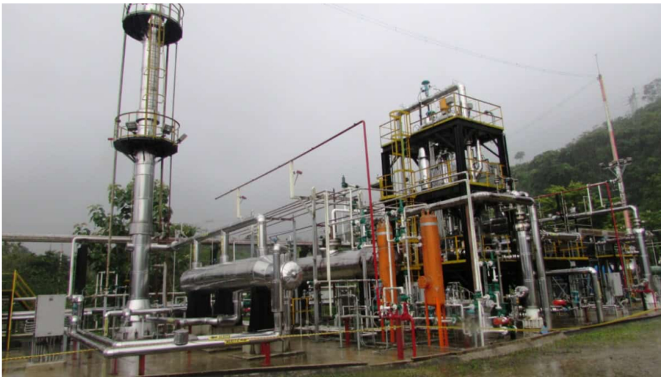
Planta de gas Gibraltar será asumida por Ecopetrol. Foto: Ecopetrol.
