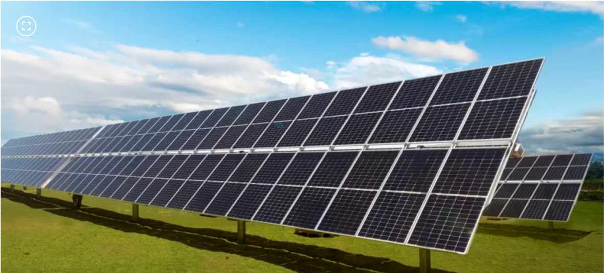
Proyectos solares de Ecopetrol ayudaron a la meta de eficiencia energética. Foto: Ecopetrol
