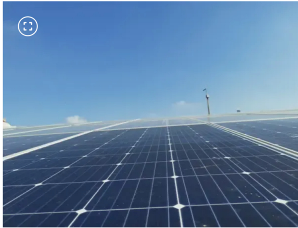
Proyectos solares de Ecopetrol ayudaron a la meta de eficiencia energética. FOTO: CORTESÍA: ECOPETROL
