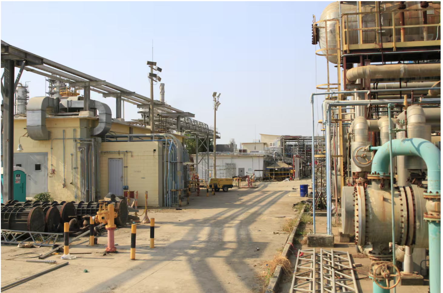
Instalaciones de la Refinería de Cartagena -Ecopetrol
