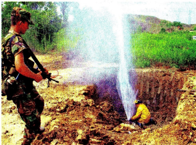
El robo de combustibles se hace con válvulas clandestinas como la del operativo de esta imagen. FOTO: ARCHIVO
