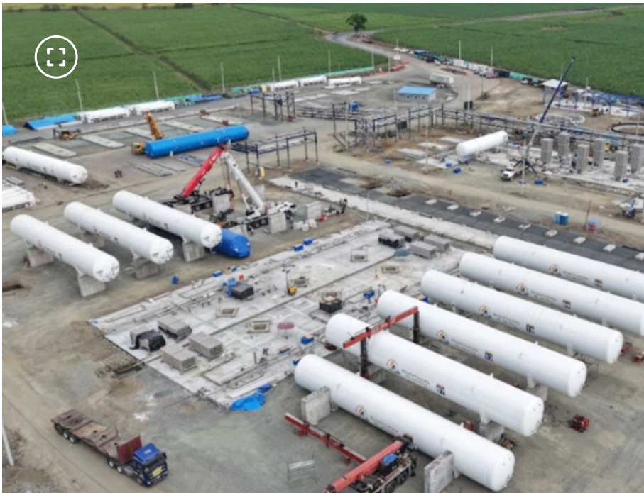
Regasificadora del Pacífico FOTO:REGASIFICADORA DEL PACÍFICO
