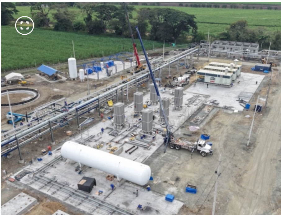
Regasificadora del Pacífico FOTO:REGASIFICADORA DEL PACÍFICO
