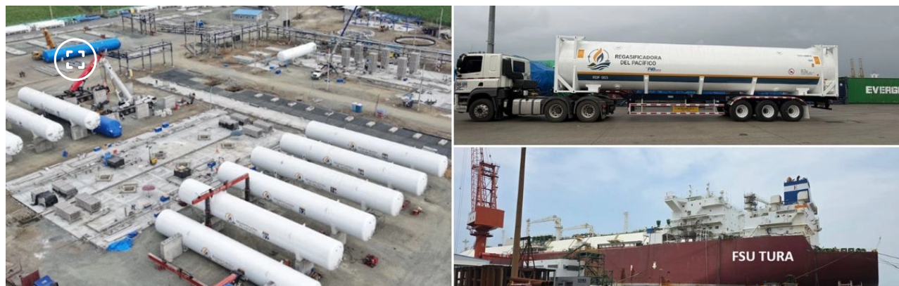
Regasificadora del Pacífico Foto: Regasificadora del Pacífico
