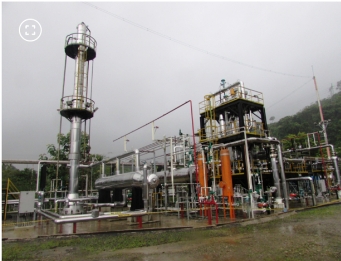
Planta de gas Gibraltar FOTO: ECOPETROL
