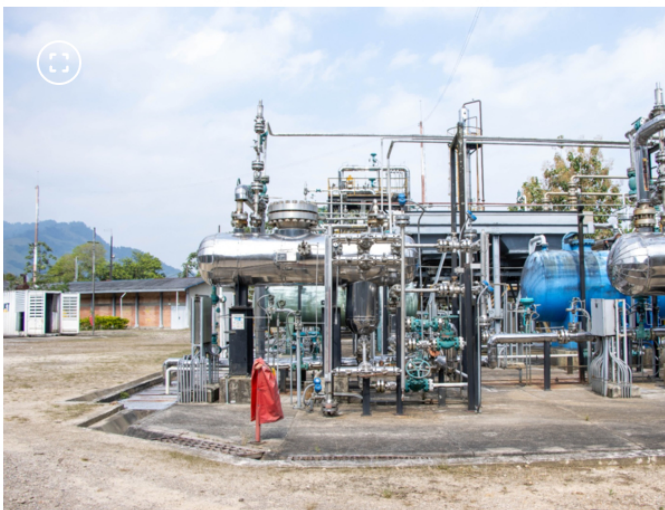
Planta de gas Gibraltar FOTO: ECOPETROL
