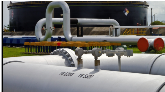
Oleoducto de Cenit Cortesía: Ecopetrol
