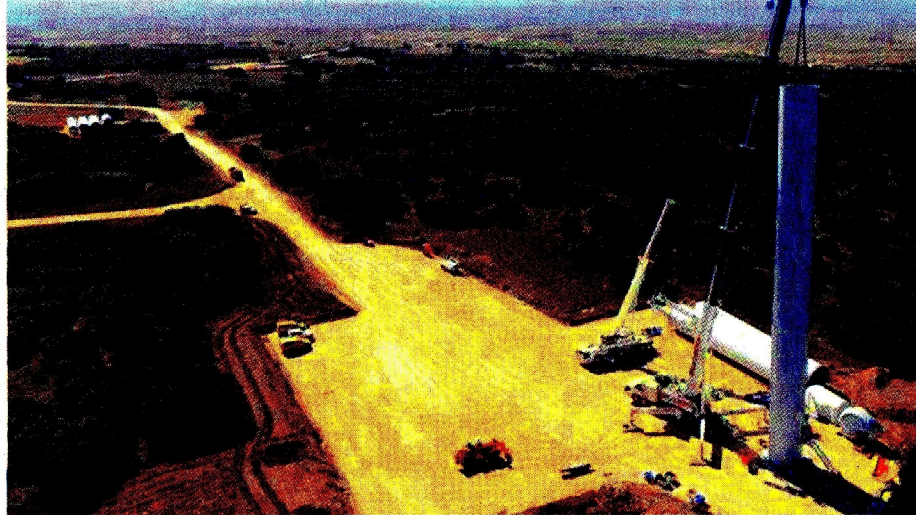
De acuerdo con un reporte de la Upme, a diciembre de 2024 Windpeshi acumulaba un avance en el cronograma de construcción del 64 por ciento. FOTO: ENEL GREEN POWER
