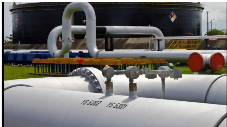
Oleoducto de Cenit Cortesía: Ecopetrol
