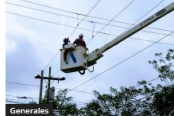
Redes de los sectores eléctricamente subnormales no son de la empresa: Air-e
