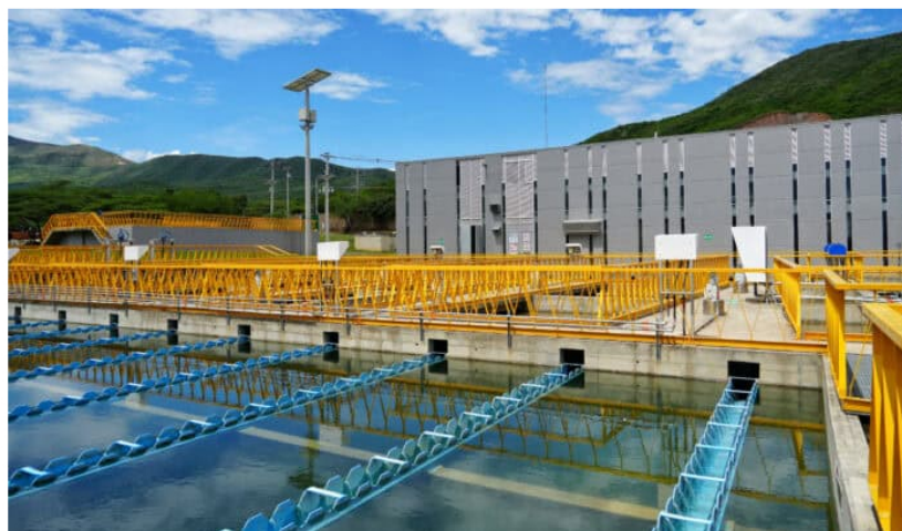
Sistema de acueducto metropolitano que beneficiará a Cúcuta, Villa del Rosario y Los Patios. Foto: cortesía.
