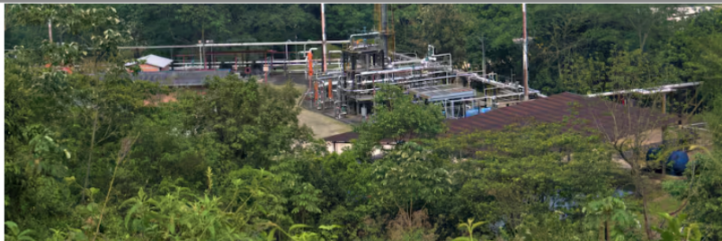
Infraestructura del campo de Gas Gibraltar (Norte de Santander).
