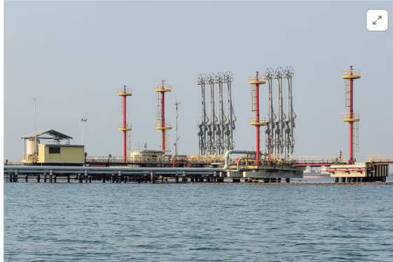
[1/2] FOTO DE ARCHIVO. Complejo de tuberías utilizadas para la exportación de crudo en un muelle que hace parte de la refinería de Ecopetrol, en Cartagena, Colombia 12 Abril, 2024. REUTERS/Nelson Bocanegra Purchase Licensing Rights
