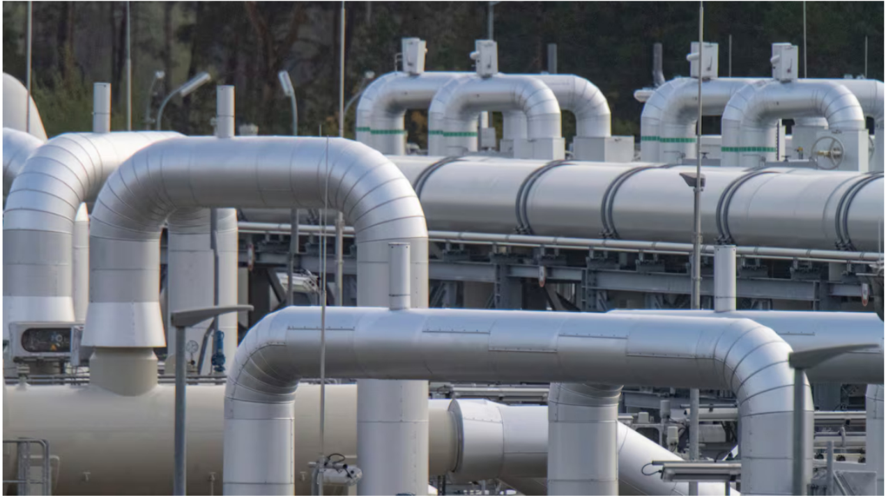
Tuberías de gas. Foto de referencia. | Foto: AP
