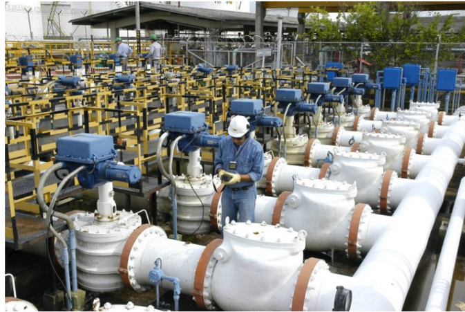
Foto: Ecopetrol / Refinería de Barrancabermeja.
