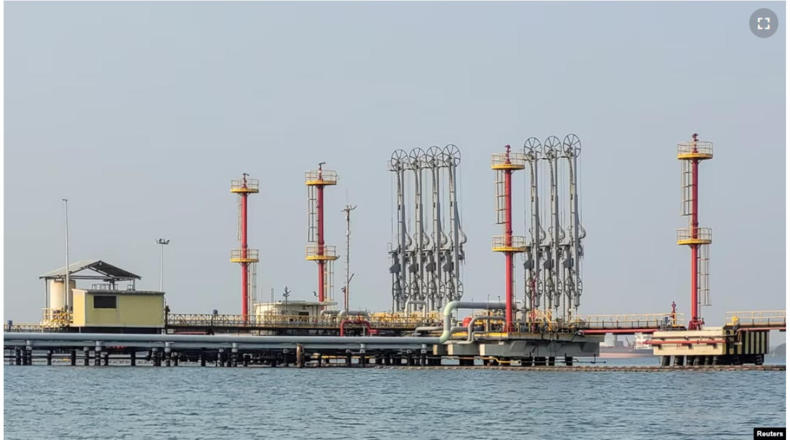
Un complejo de tuberías utilizadas para la exportación de petróleo crudo en un muelle que forma parte de la refinería de Ecopetrol , se ve en Cartagena, Colombia, el 12 de abril de 2024.
