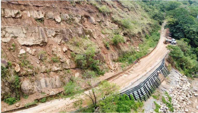
La situación es crítica en el sitio denominado El Viejo, en el tramo que une a Yopal con El Morro. Foto: archivo particular
