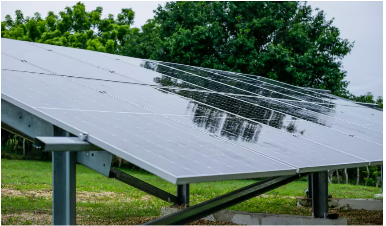
Una de las instalaciones solares ubicada en Canutal, Sucre.
