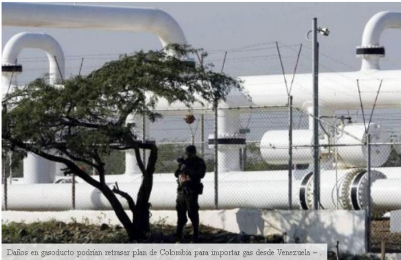
Daños en gasoducto podrían retrasar plan de Colombia para importar gas desde Venezuela - .
