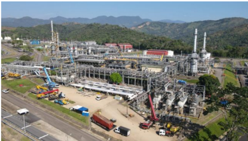
Planta de Gas de Cupigagua
