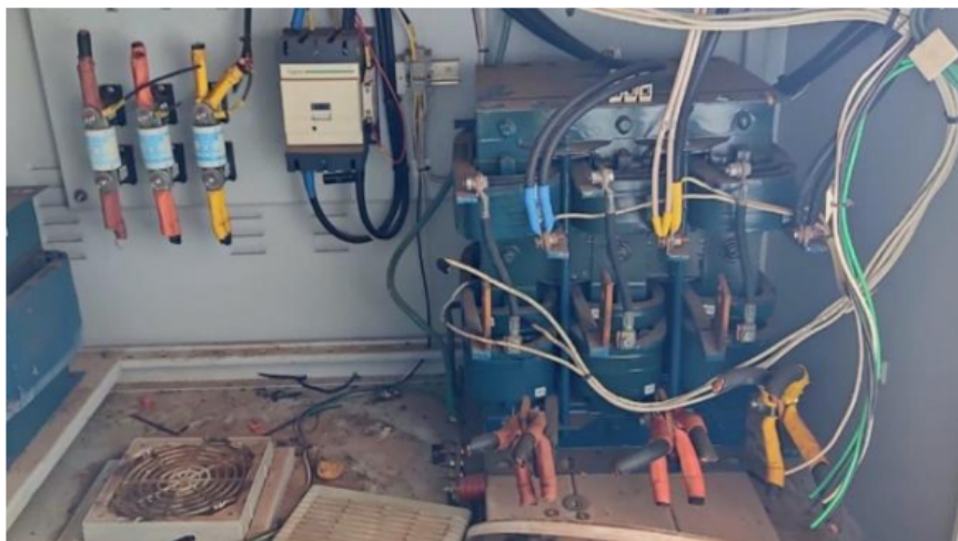
Daños causados a equipos del campo Quifa para ejecutar el hurto de cobre.
