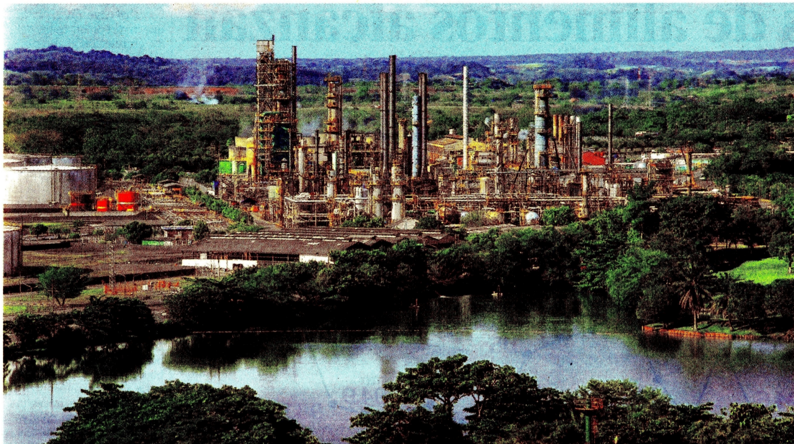
La Refinería de Barrancabermeja alcanzó una carga de 216,3 kbd en el tercer trimestre de 2024 y 223,5 kbd en los nueve primeros meses del año. Foto: Ecopetrol
