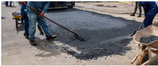
Obras de pavimentación entre Boston y Vía Yuma en Barrancabermeja (Fotos suministradas por Ecopetrol / VANGUARDIA)
