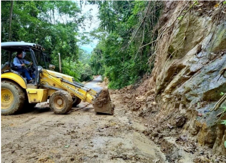
A partir de la fecha se iniciará un plan de limpieza y reparcho del tramo vial entre el Puente La Cabuya y el centro poblado de El Morro. Foto: archivo particular
