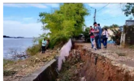
Afectación de la muralla de contención en el municipio de Puerto Wilches
