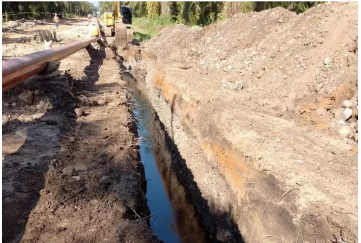
derrame de crudo en vía de Barrancabermeja
