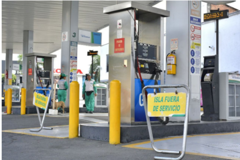
Así permanecen las estaciones de gas, luego de que personal de la empresa Gases de Occidente, que surte de gas a la región, cerrara las válvulas de suministro de gas vehicular. | Foto: Jorge Orozco
