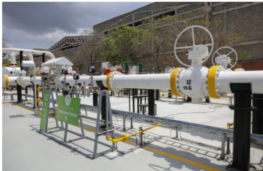
Primer piloto de Hidrogeno Verde en la Refinería de Cartagena. Foto MinMinas
