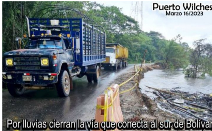
Por erosión en la ribera, cierran vía que conecta al sur de Bolívar
