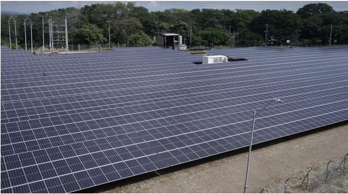
Este proyecto cuenta con 4 hectáreas y 9.600 paneles solares. - Foto: Alcaldía de Cúcuta
