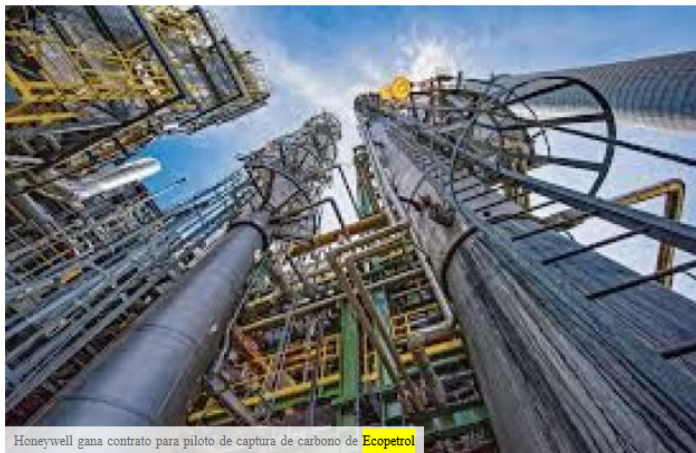
Honeywell gana contrato para piloto de captura de carbono de Ecopetrol
