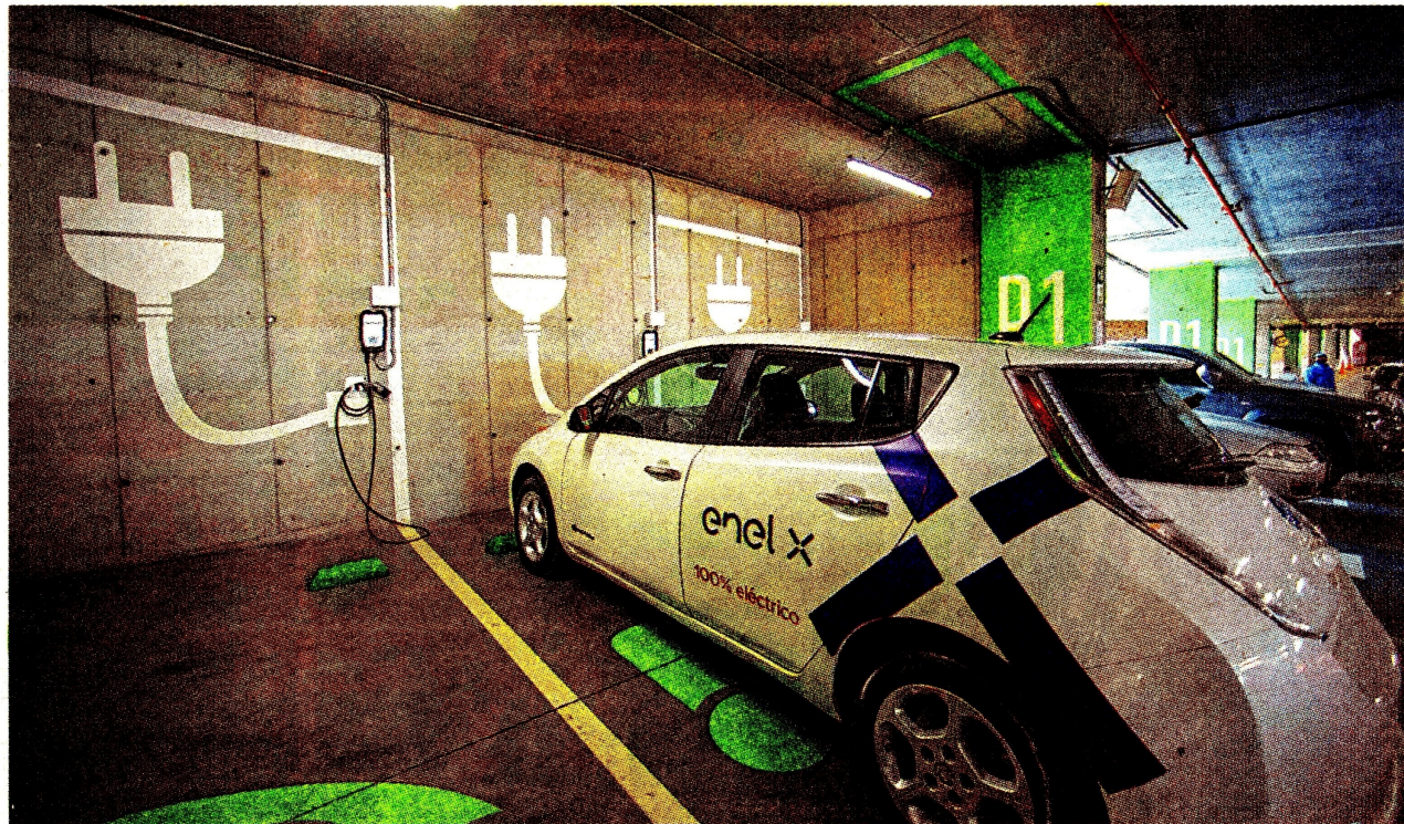
El precio del kilovatio en una carga lenta está entre los $1.000 y $1.100 y el de la carga rápida entre $1.200 a $1.400, según Enel.
