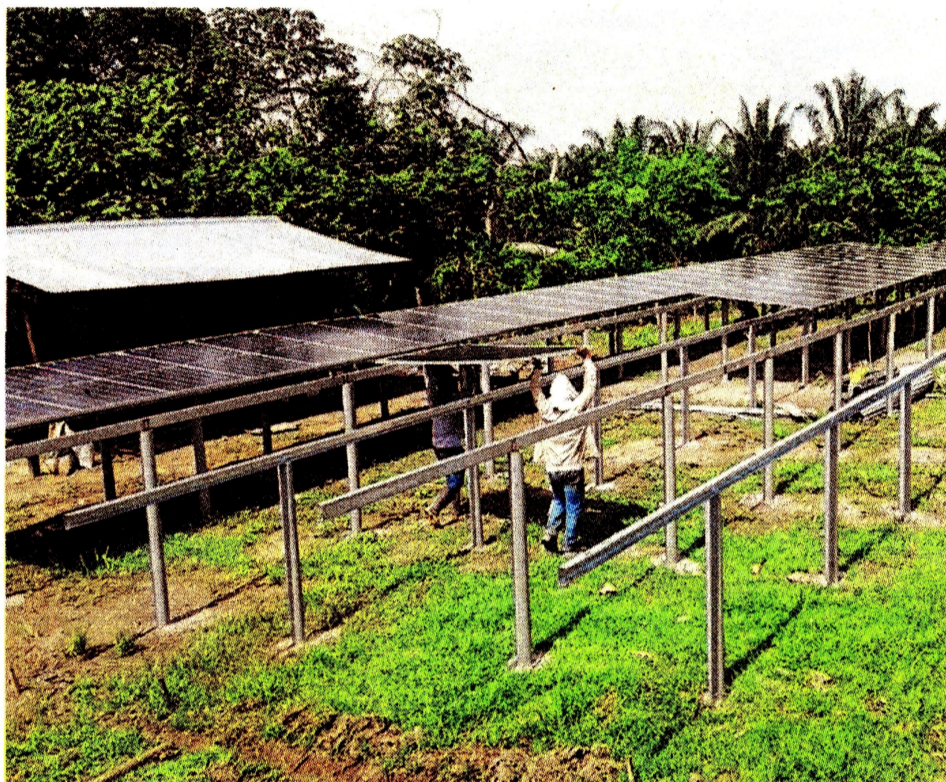
Cuando los sistemas de energía solar solo se utilizan de día, no utilizan baterías.
