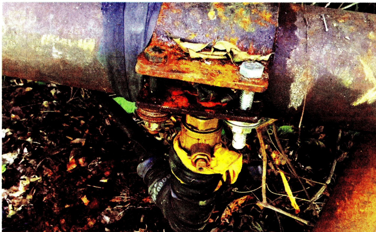
El crudo de contrabando se mezclaba con el que se obtenía con válvulas ilegales en el oleoducto Caño Limón-Coveñas. Ecopetrol
