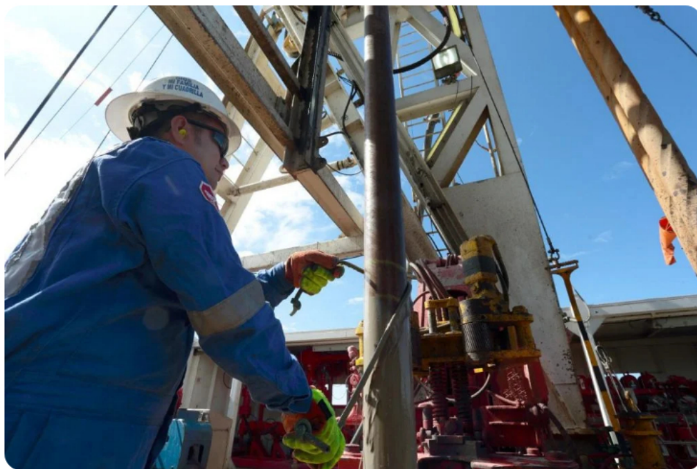
Taladro petróleo. Foto: Ecopetro .
