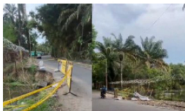
Comienzan las obras para solucionar la socavación en la vía del Club Infantas
