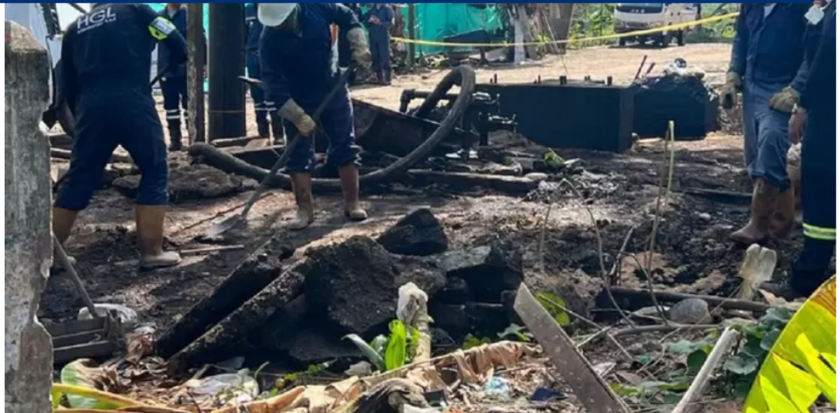
Derrame de crudo.
