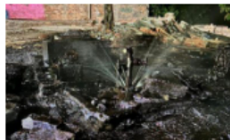
Manipulación de válvulas por terceros ocasionó daño ambiental
