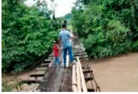
Arriesgan su vida al cruzar puente deteriorado en vereda de Cimitarra
