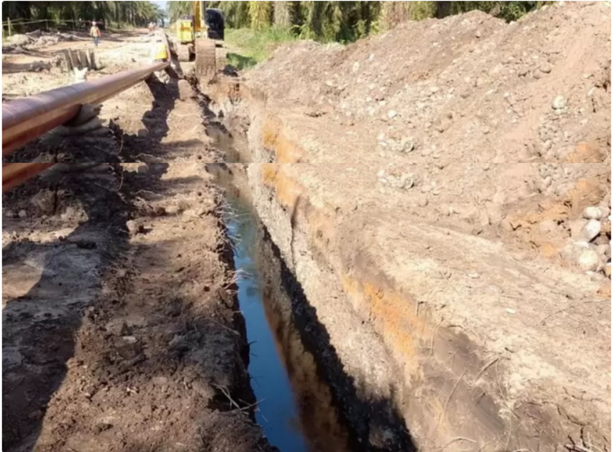
📍 derrame de crudo en vía de Barrancabermeja
