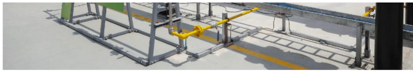
Promigas producirá hidrógeno verde para inyectarlo en la red de gas natural en la zona de Mamonal en Cartagena. Foto: MinEnergía - Cesar Nigrinis - Foto: MinEnergía - Cesar Nigrinis
