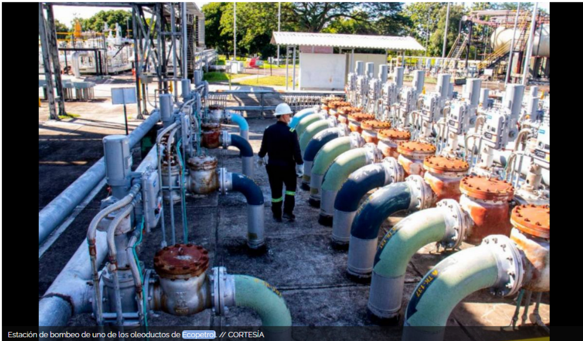
Estación de bombeo de uno de los oleoductos de Ecopetrol // CORTESÍA
