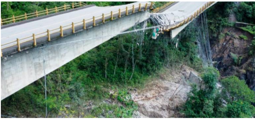
Colpaso del puente Los Grillos en la vía Los Cruceros – Aguazul, en la Transversal del Cusiana (Boyacá). FOTO MinTransporte
