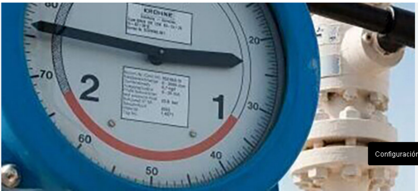
Estación Baumgarten gas en Austria. FOTO: OMV
